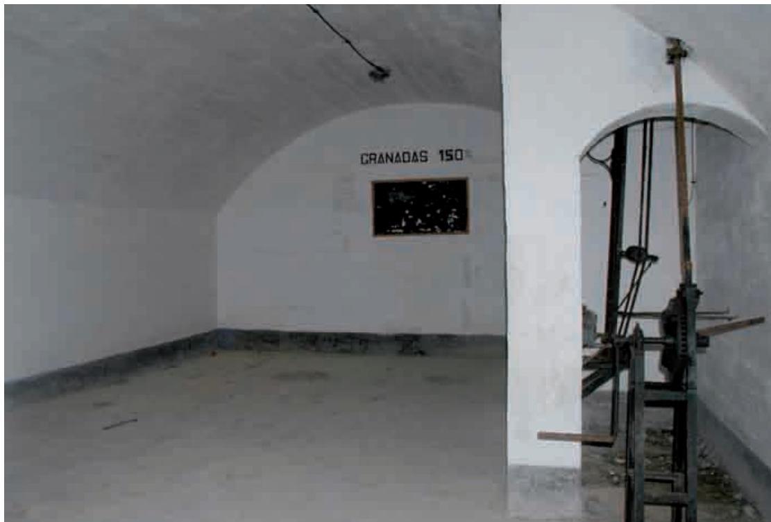
Figura 269. Banco de Ibiza. Sala de repuestos de una pieza de artillería con montacargas electromecánico a la derecha.
