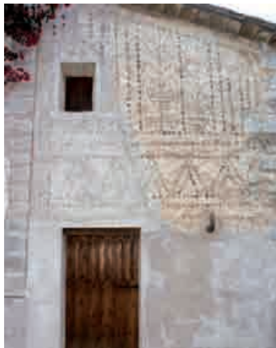
Figura 400. Fachada del cuerpo adosado a la izquierda del cuerpo principal de la "possessió" de Mofarés.
