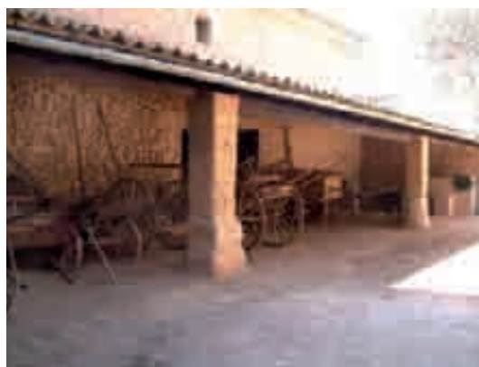
Figura 446. En el caso de Santa Ponça, los establos se sitúan en un cuerpo lateral del conjunto. Éste es de planta longitudinal, dos plantas y cubiertas a doble vertiente con un porche en la primera planta sustentado por gruesos pilares de arenisca, con función de cochera.
