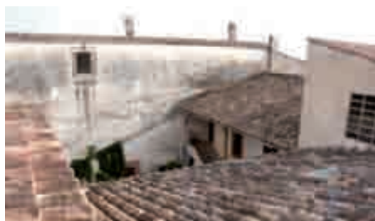
Figura 381. Disposición de las cubiertas de los cuerpos que cierran el patio de la "possessió" de Mofarés.
