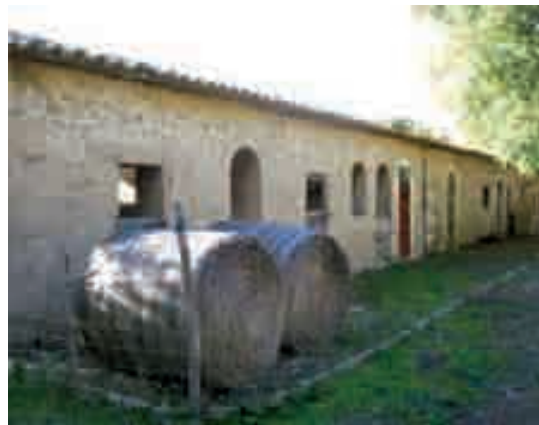
Figura 449. Porquerizas de la "possessió" de Son Claret, de cuerpo longitudinal y una única planta con vanos de diferente forma, que dan acceso en el interior a distintos cubículos.
