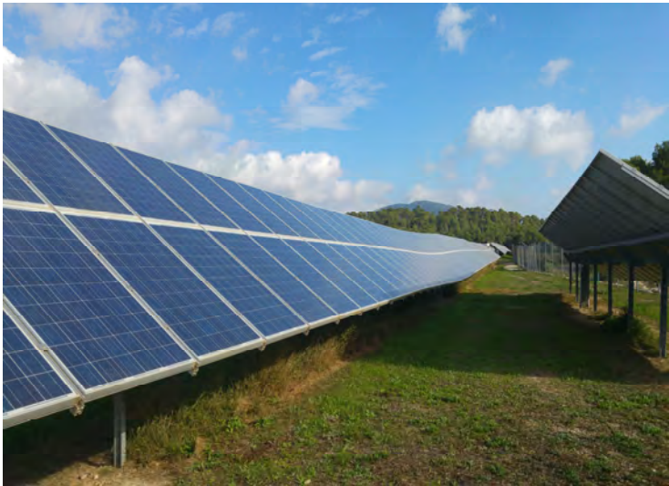
Imatge 5. Fotografia del camp fotovoltaic.
