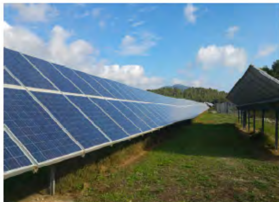
Imagen 5. Fotografía del campo fotovoltaico.
